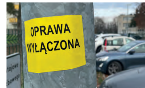
Zdjęcia oznaczonych słupów z wyłączonymi w ramach oszczędności oprawami ulicznymi.
